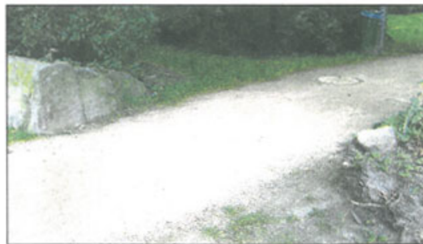
Beschädigte Steinfassung am Ortseingang.
